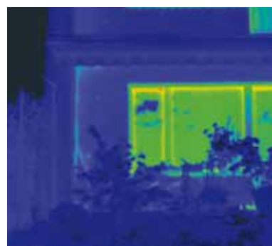
Na zorgvuldige inbouw van nieuwe Schüco Corona CT 70 Accent kozijnen bewijst de thermografie het hoge energiebesparingpotentieel van de investering. Het oorspronkelijke energieverlies wordt maximaal gereduceerd.
